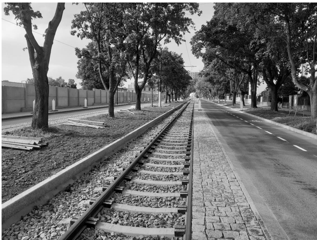
Obr. 8. Pohled na kolej s částečně pojízditelným zákrytem vně kolejnice [T.P.]
