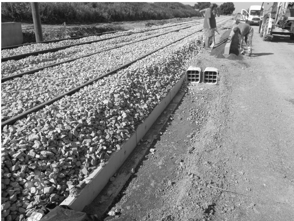
Obr. 4. Kabelová trasa v místě přerušení multikanálu [K.O.]
