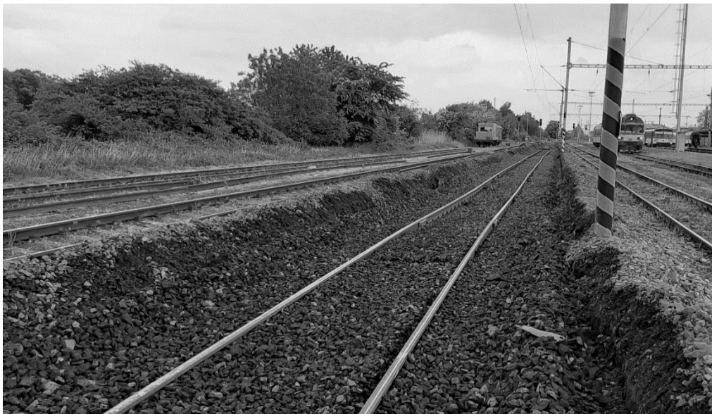
Obr. 4 Pohled na kolej v železniční stanici po průjezdu strojní čističky kolejového lože, při kterém došlo k narušení příčných sklonů a systému odvodnění, zdroj: Ing. Radek Vandrovec [7]
